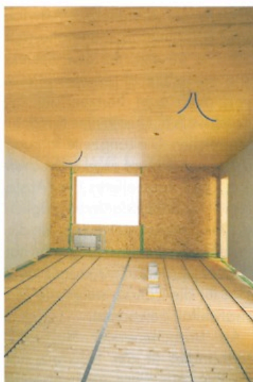
Beim Deckensystem im Holz-/Betonverbund kommt der Doppelnutzen von Funktion und Gestaltung zum Tragen. Foto: -bo-
